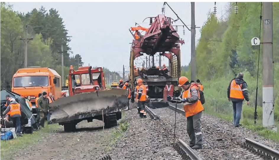
В результате срабатывания неустановленного взрывного устройства было повреждено железнодорожное полотно и с рельсов сошел локомотив и несколько вагонов грузового состава
