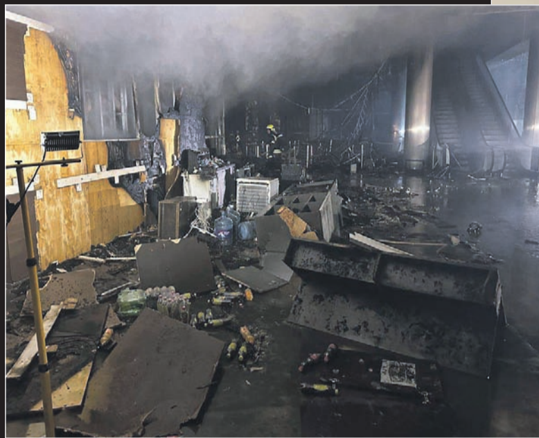
Выгоревшее помещение «Крокус Сити Холла»
